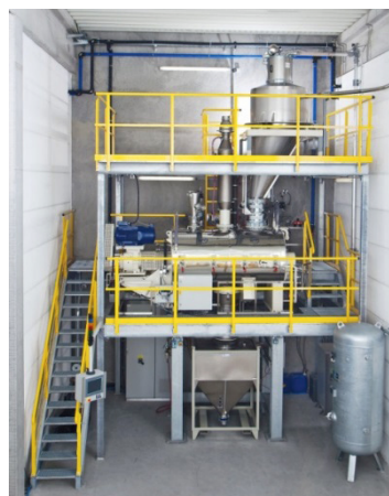
PE-Xa-Mischanlage bei Agru-Frank GmbH, Mörfelden
