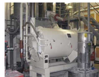
Nachher: Neue Heiz- und Kühlmischerbehälter
